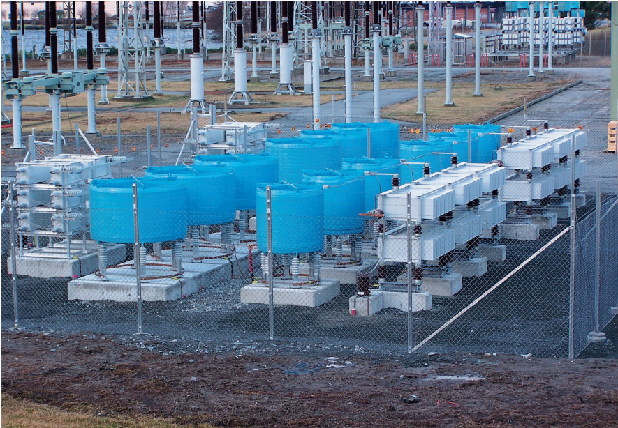
На фото два 7,74 Мвар фильтра гармонических токов 3-го порядка (слева сзади) и два 17,6 Мвар фильтра гармонических токов 5-го порядка (справа спереди). Реакторы фильтров изготовлены по новой технологии. Алюминиевый завод компании Сёр-Норье Алюминум А/С пос. Хуснес, Норвегия.
