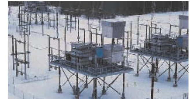
Рис.4. Один из секторов последовательной конденсаторной установки 301 МВАр, 400кВ, 50Гц подстанции в г.Кеминмаа, Финляндия
