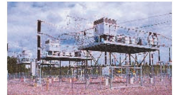
Рис.5. Последовательная конденсаторная установка 105,9 МВАр, 400 кВ, 50Гц подстанции в г. Ууснивала, Финляндия.
